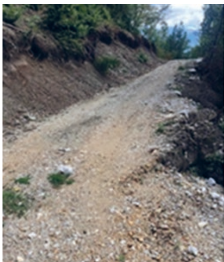
Slika 5. Oštećenja na kolniku Figure 5. Damage on the pavement
