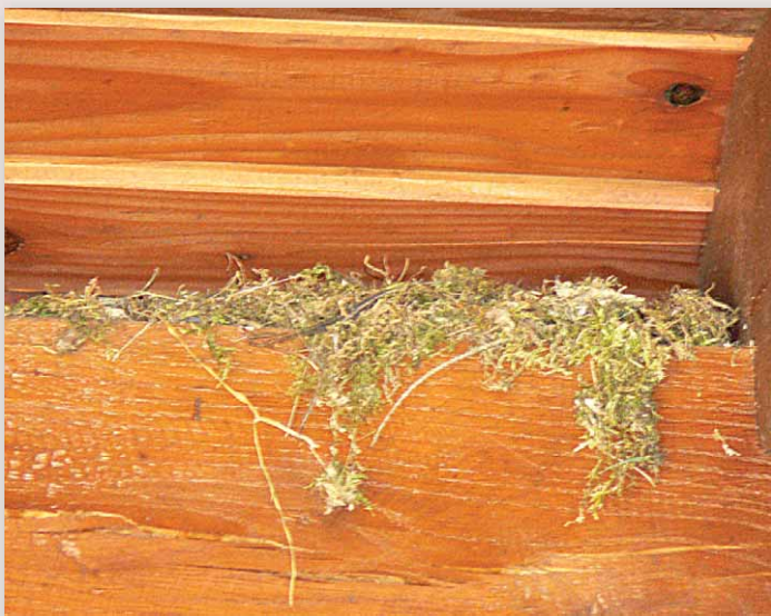
Gnijezdo smješteno na krovnoj konstrukciji šumskog objekta
