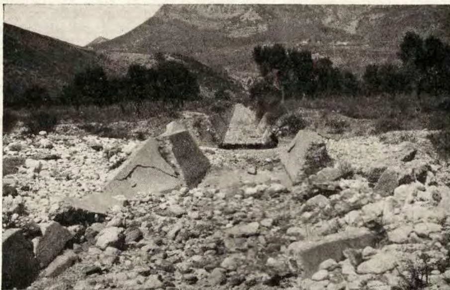
Sl. 2. Porušen kanal na čunu nanosa. U preseku porušenog kanala na zadnjem planu vidi se prvobitna izrada sa relativno tankim zidovima. Projektanti popravaka mislili su, da ta debljina nije dovoljna i izradili su umesto porušenog dela nove zidove sa mnogo većom debljinom. Ali pošto je ta pretpostavka bila pogrešna, ista sudbina stigla je i debele zidove.
